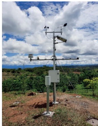
Instalación de EAMA-Potreriillo (DZ09)
