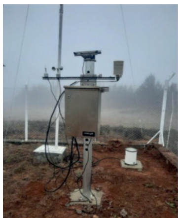
Instalación de una EMA básica en la estación CO Alto Puclus (DZ01) Instalación de EAMA-Potreriillo (DZ09)
