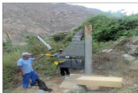
Mantenimiento correctivo EMHA de Aforo OTT proyecto PSI
